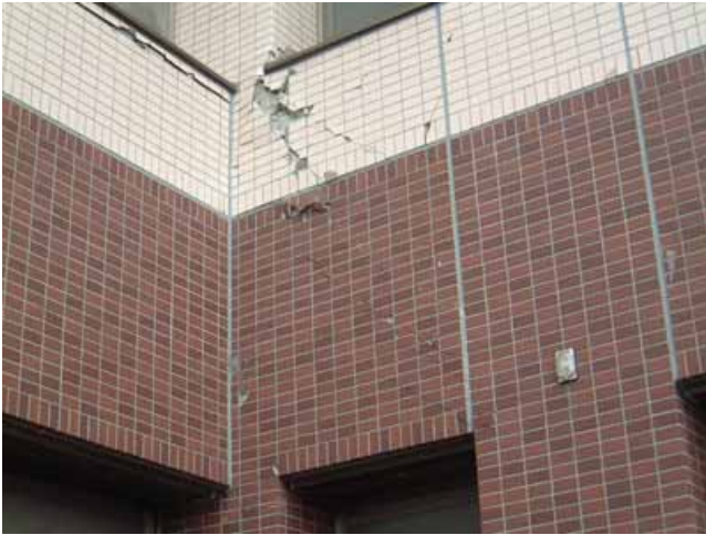
写真41： 地域共同テクノセンターの入隅部分 2階梁が短スパンとなっており，せん断ひび割れが入っている。
