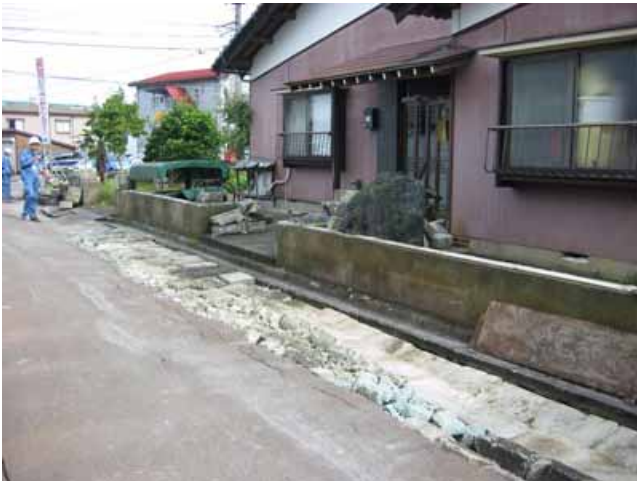
写真25：大谷石の塀の転倒
