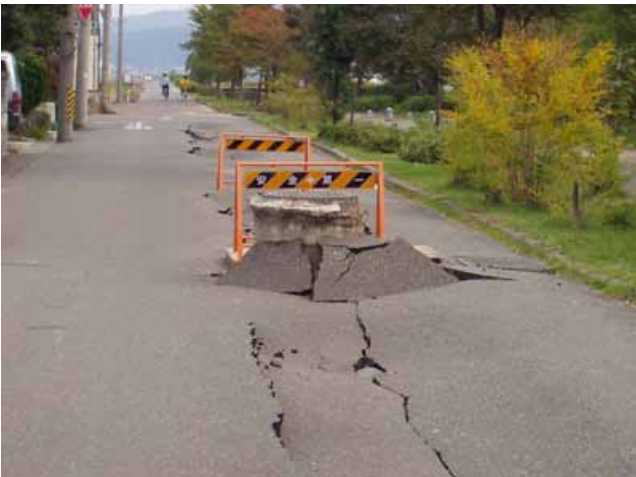
写真33: 道路の陥没とマンホールの浮き上がり 配管を埋めた部分で、道路の陥没とマンホールの浮き上がりが連続的に並んでいる。
