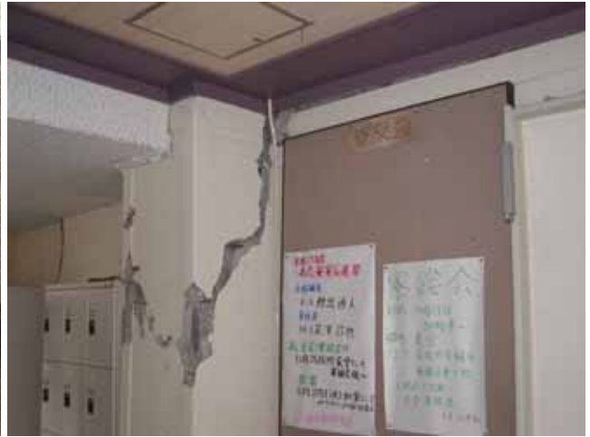
写真42： 1階柱のせん断破壊(学生寮) 地震力ではなく，地盤の強制変形により破壊したとも考えられる。
