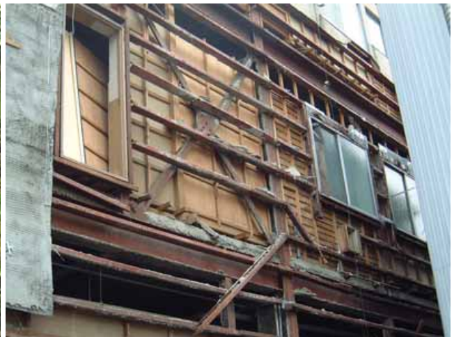
写真18: 3階建て鉄骨建物の外壁の剥落 ブレースのボルトが見られない。破断して落ちたのか、初めからなかったのかは不明。
