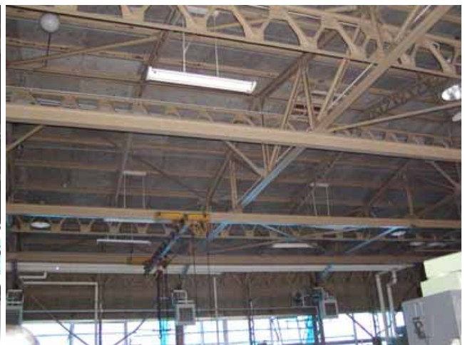
写真52： 写真51の建物の屋根部分 梁はリベット接合によるトラス. 屋根面はアングルのブレースを用いている. 被害は見られない.
