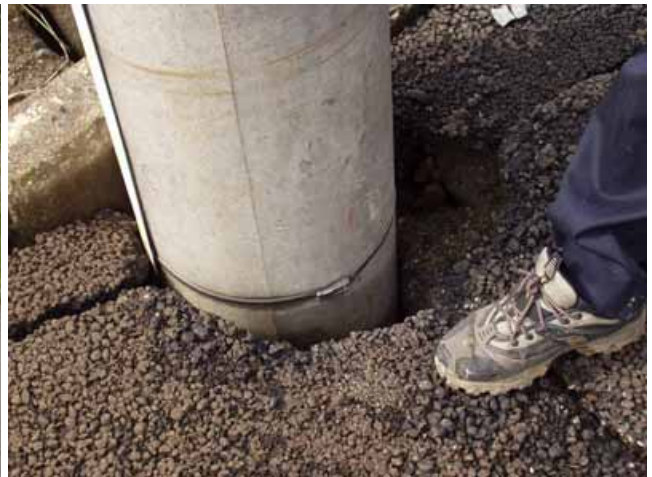
写真34: 地盤の液状化による電柱の沈下
