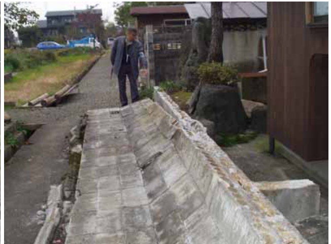
写真26：コンクリートブロック塀の転倒
