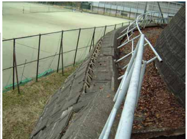
写真56：擁壁コンクリートブロックの変形 擁壁がはらみだして、危険な状態。
