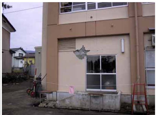
写真24: 複数開口を有するRC壁の被害 開口をつなぐようにせん断破壊している. ただし, 建物全体としては軽微な被害.
