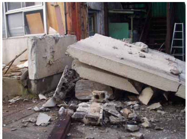
写真62： 写真59の建物被害 骨組内のコンクリートブロック壁が転倒。
