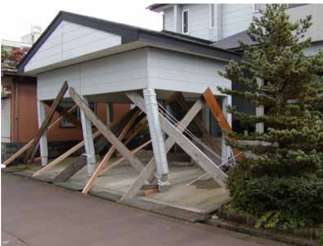
写真1：木造住宅玄関ポーチのねじれ崩壊 ポーチ奥の柱はほぼ垂直に立っているものの、手前の柱は大きく傾いている。
