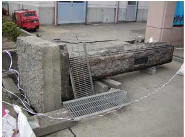
写真28：門柱の転倒(長岡市立石坂小学校)
