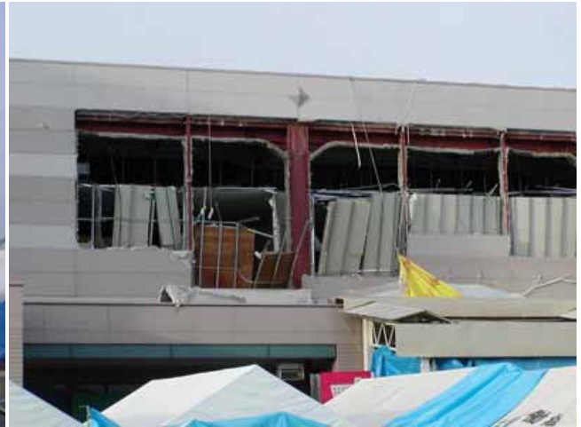
写真64: 写真63の建物の近景 外壁以外に、天井も落下している.
