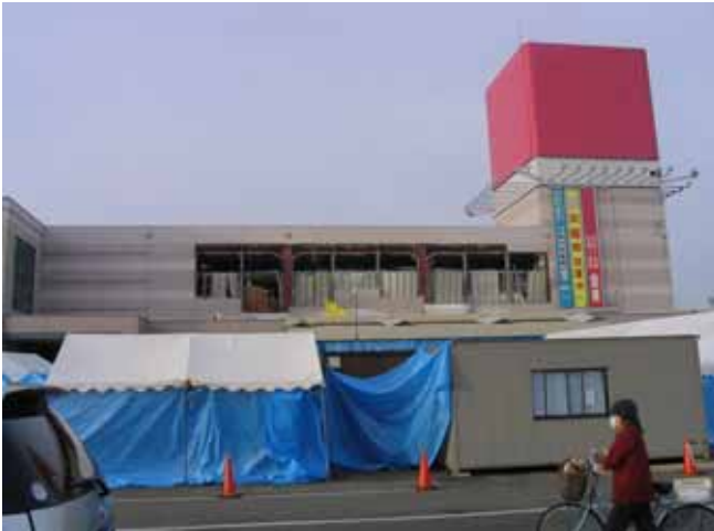
写真63: 鉄骨造2階建て商業施設 外壁(ALC版)の剥落.
