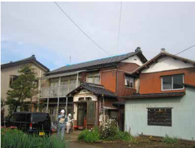
写真5： 木造2階建て住宅の棟瓦の落下 建物全体の变形はほとんど見られない．
