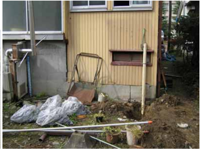
写真10: 写真9の建物の基礎ひび割れ この住宅は、判定項目のほとんどでBランクとなり 「要注意」判定の中でも危険な建物.
