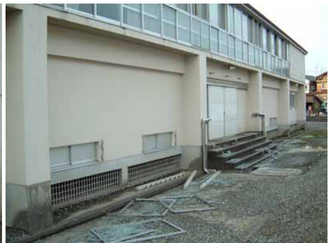
写真68: 1階RC造2階S造の体育館 1階壁は無被害であるが、窓ガラスが飛散.
