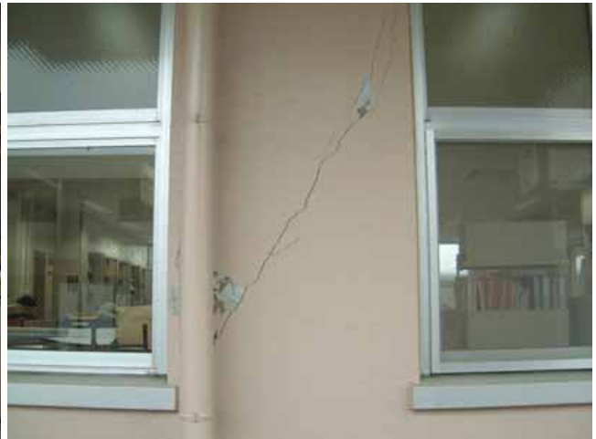
写真38: 写真37の建物の1階柱せん断ひび割れ この柱だけにせん断ひび割れが見られた。
