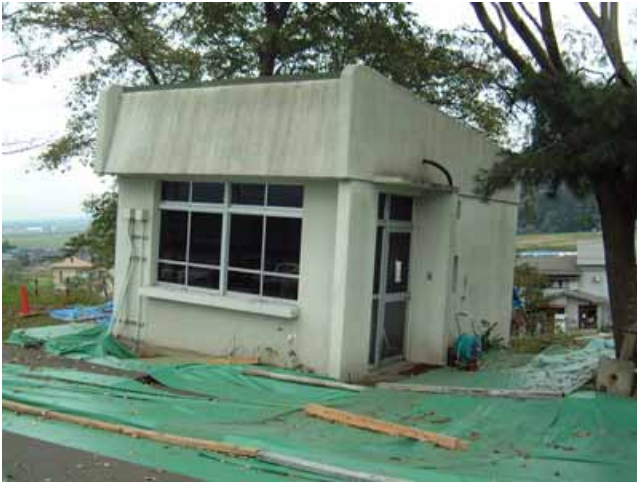
写真35: 地盤変状による全体傾斜 躯体は無被害。
