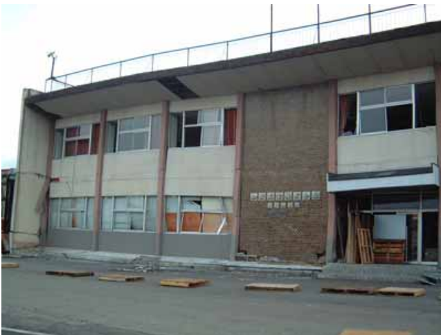
写真59： 大破した鉄骨造2階建て事務所
