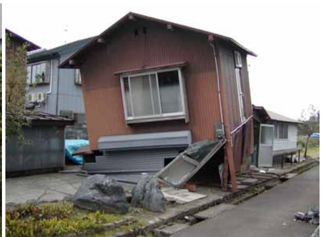
写真2：木造2階建て納屋のねじれ崩壊 1階が車庫で、壁・筋かいがコの字に偏って配置されていることが原因。
