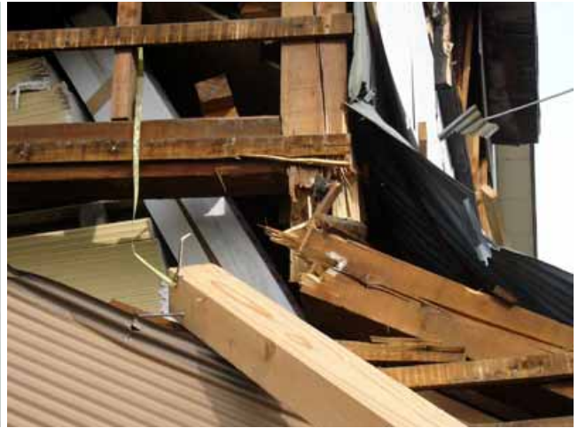
写真4： 写真3の建物の接合部詳細 柱が折損している．2階の積載荷重が過大であ ったとも考えられる．
