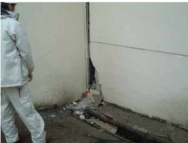
写真67: 写真65の建物の被害 渡り廊下の取り付け部の損傷.
