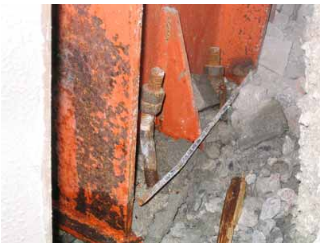
写真61： 写真59の建物の露出柱脚 アンカーボルトの引き抜け。
