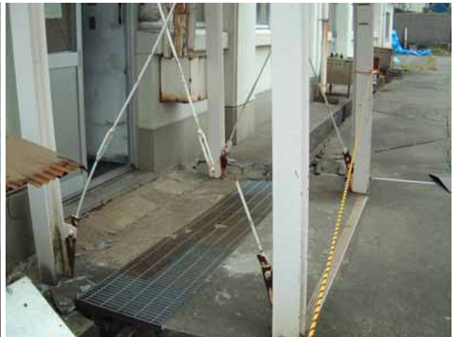
写真50： 渡り廊下部分のブレースの被害 丸鋼ブレースの座屈と破断. 右側の柱が沈下したことによる被害と考えられる.
