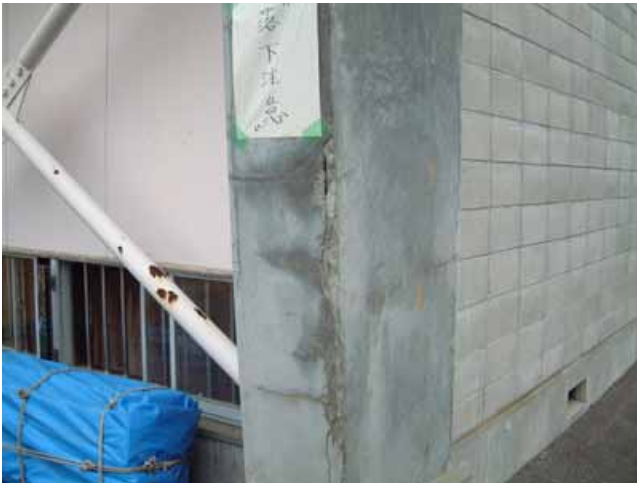
写真49： 鉄骨造体育館の被害 ブレースおよびコンクリートブロックは無被害. 柱のかぶりコンクリートにひび割れあり.
