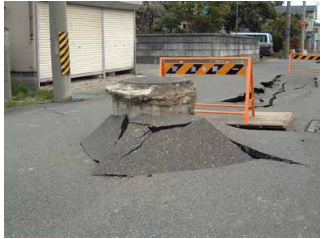
写真32: マンホールの浮き上がり
