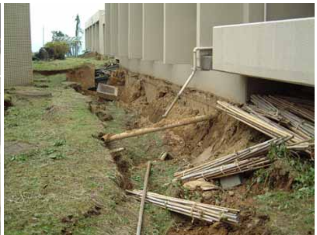
写真46： 地盤の崩壊による基礎部分の露出 地盤は左側に移動。
