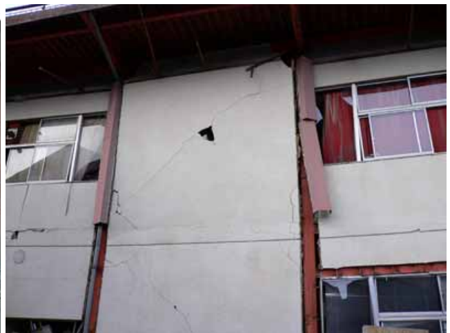
写真60： 写真59の建物被害 外装材のせん断破壊。
