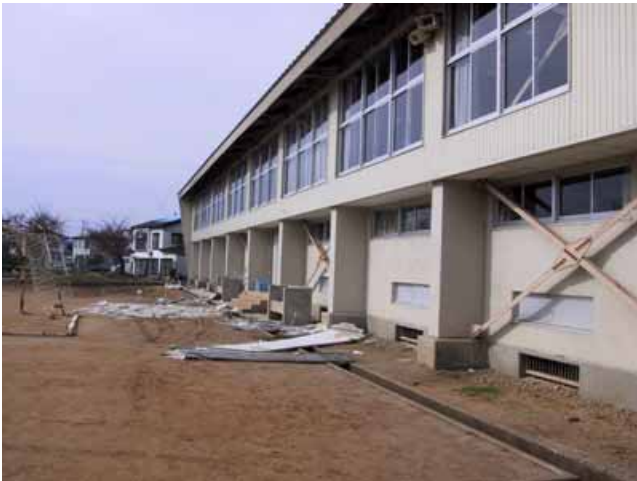
写真19: 鉄骨造体育館の軒天井の剥落
