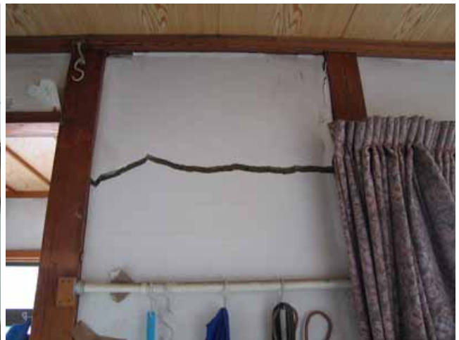
写真6： 写真5の建物内部 土壁(漆喰仕上げ)の割れ．応急危険度判定で は「要注意」の判定．
