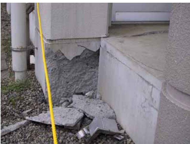
写真23: RC造建物の1階柱脚の損傷 曲げ破壊によりコンクリート剥落. この写真のよう に, 一部には軽微な被害も見られる.
