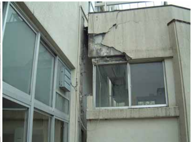
写真44： 渡り廊下取り付け部の損傷
