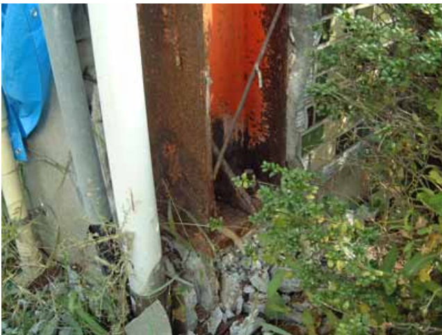
写真17: 2階建て鉄骨建物の露出柱脚の被害 基礎コンクリートが損傷。内部仕上げの剥落、ガラスの飛散などの被害も見られた。
