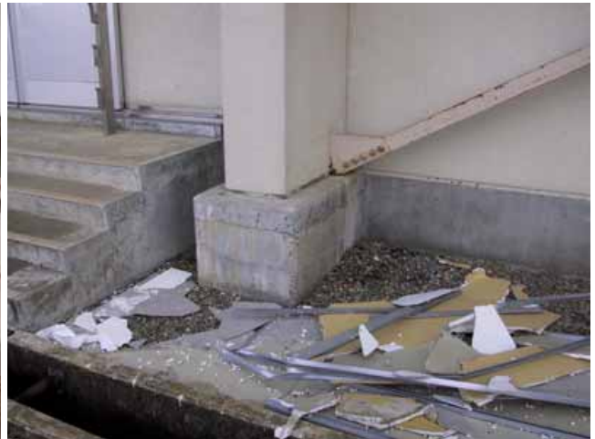
写真20: 写真19の建物近景 柱脚やブレース等, 構造被害は見られなかった.
