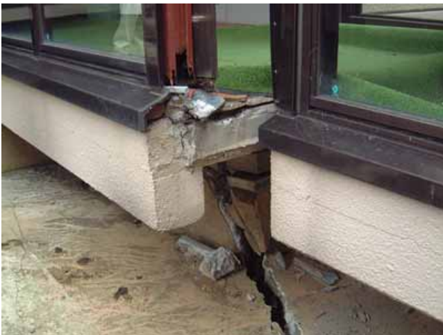
写真43： 渡り廊下のEXP. J部分のずれ 下は水槽(池)だったと思われるが，底のスラブに鉄筋が見られなかった。
