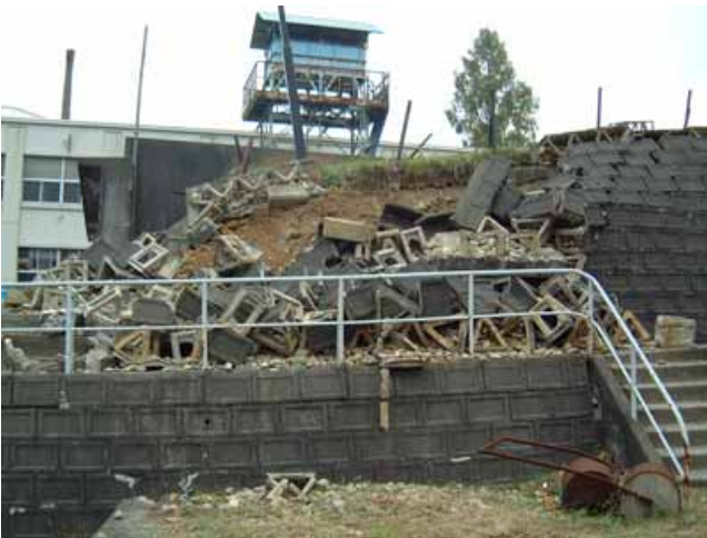
写真55：擁壁コンクリートブロックの崩壊
