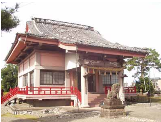
写真29：RC造神社の屋根瓦の被害
