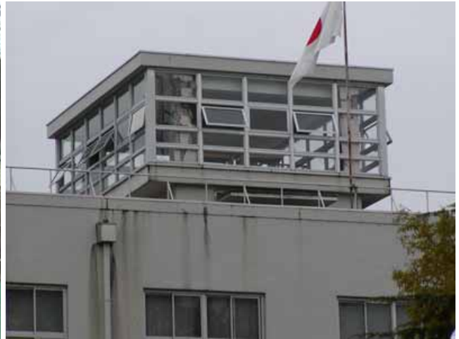
写真36: ペントハウス柱のせん断破壊(1号館)
