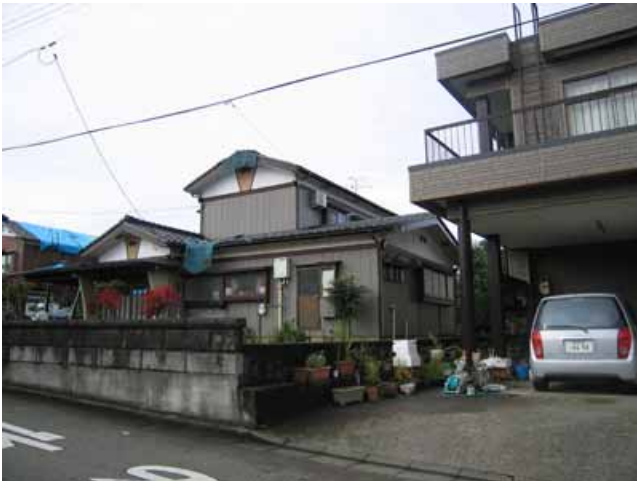
写真15: 木造2階建て住宅の棟瓦の被害 屋根瓦(棟瓦)の落下被害はいたるところで見られた。
