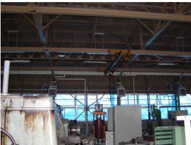
写真51： 鉄骨平屋建物のブレースの被害 奥のブレースが座屈し, さらに破断していた.
