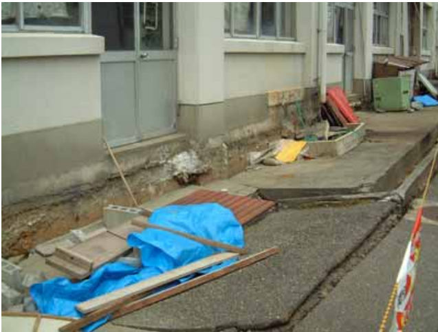
写真47： 地盤の崩壊による犬走りの損壊 地盤は右側に移動.
