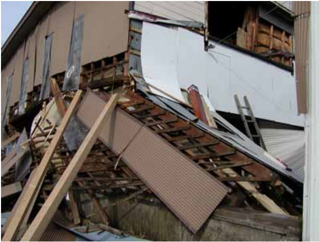
写真3： 2階建て倉庫の1層崩壊 1階の水平耐力不足が原因か？
