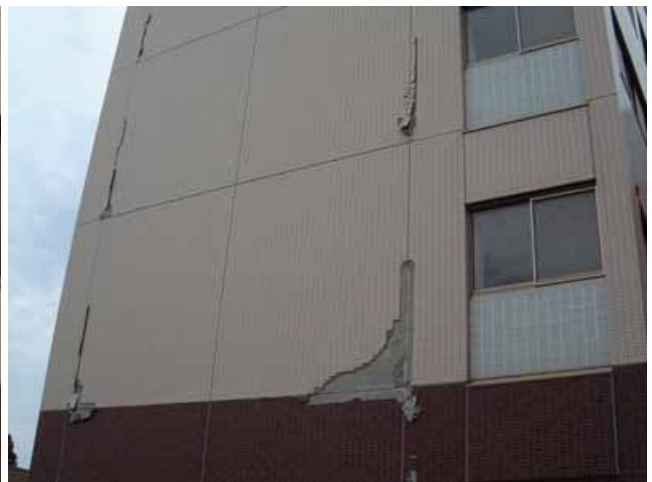
写真40: 地域共同テクノセンターの外壁の被害 外壁タイルの剥離。ガラスブロックには被害なし。
