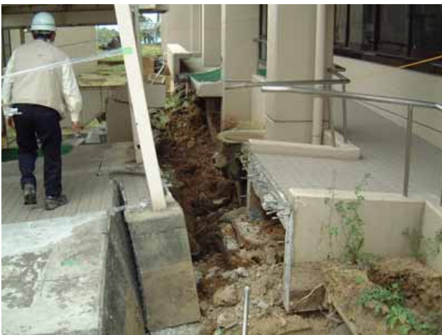
写真45： 地盤の崩壊による渡り廊下の損壊
