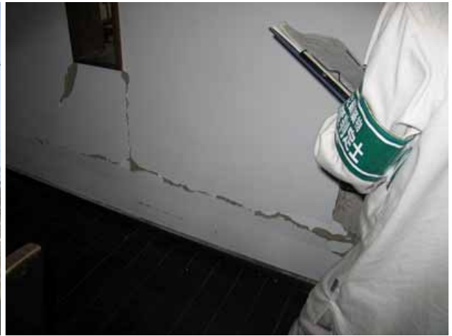
写真12: 写真11の建物内部 壁に多数のひび割れがあった。この住宅は用水 路の脇に建っており、基礎の被害も見られた.
