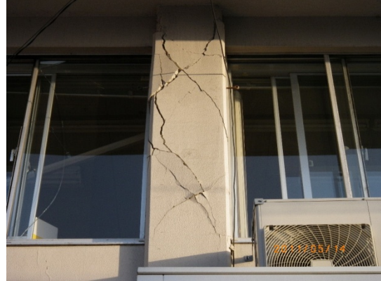
写真 25：柱のせん断破壊
