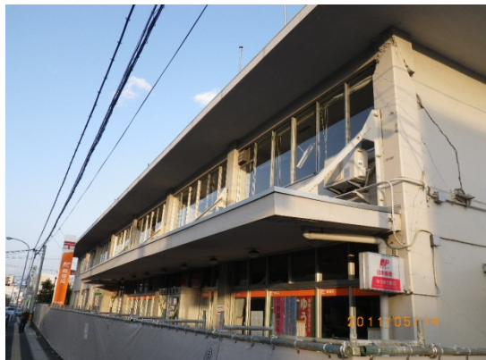
写真 29：底吊り材により柱の崩壊
