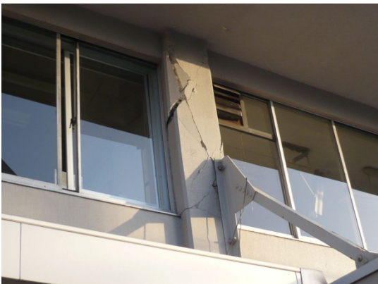
写真 28：底吊り材アンカーの抜けだし
