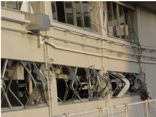
写真 26：柱のせん断破壊
