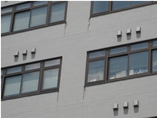
写真7：両側スリット部タイル剥落
