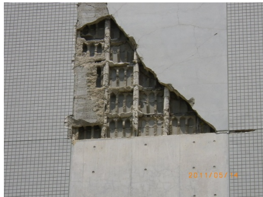
写真8：ブロック帳壁崩壊
