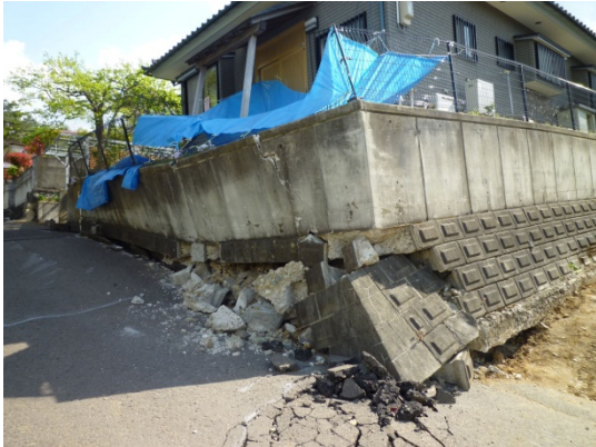
写真12：地滑りによる擁壁の崩壊
