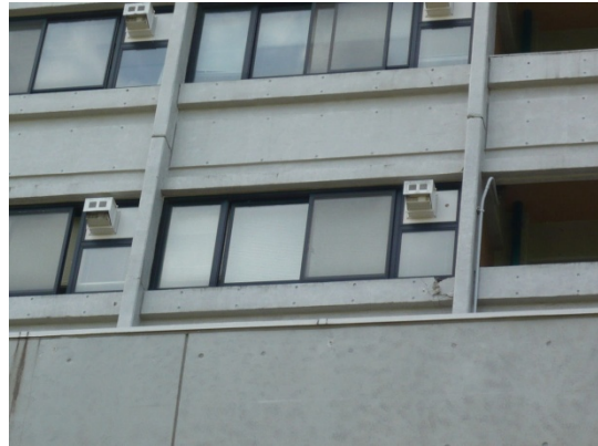
写真 2：外壁雑壁の破壊
