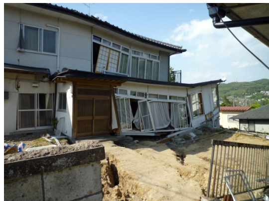
写真15：宅地が谷側に滑っている
