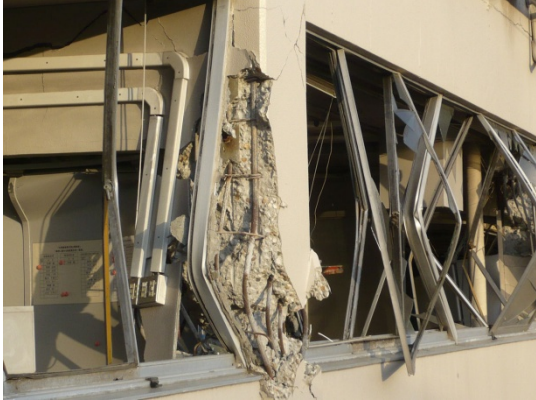
写真 24：柱のせん断破壊
