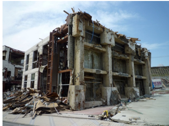
写真 41：転倒した鉄骨建物
