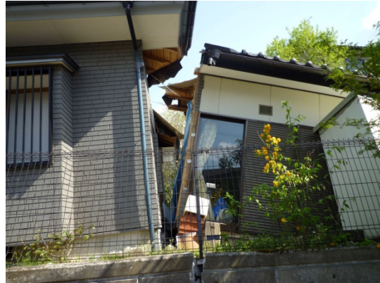
写真13：地盤陥没により接続部で崩壊
