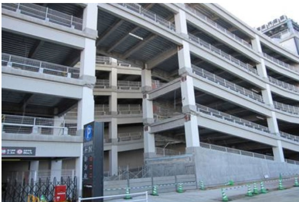
写真 22：車路の崩壊（宮城県事務協より提供）
